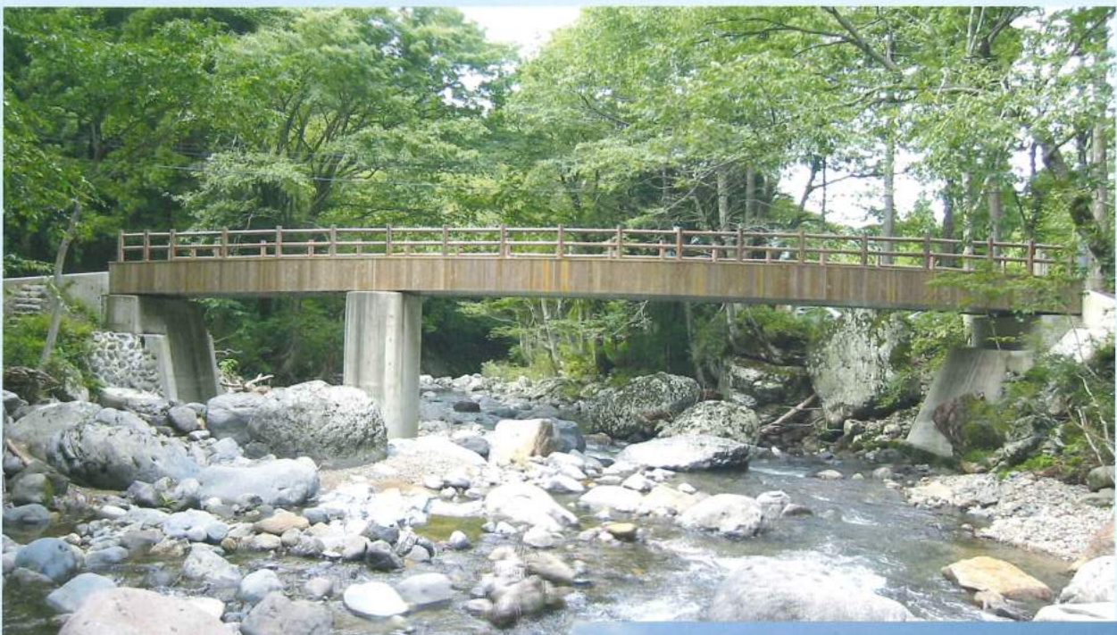
久保橋上部工架替工事 橋長24.80m(7.40+17.40) 石川県小松市(平成16年5月架)
